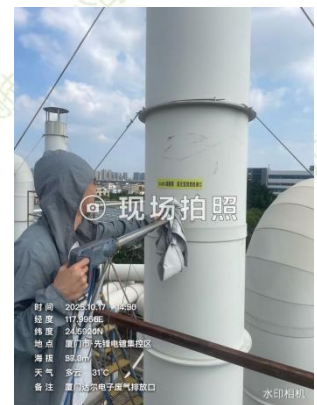
酸雾废气排放口
